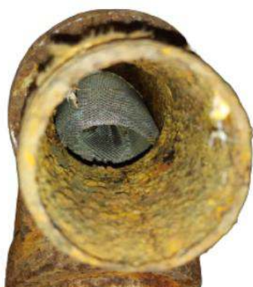
TUBERÍA CON SARRO PREEXISTENTE ANTES DE TRATAMIENTO DEI
